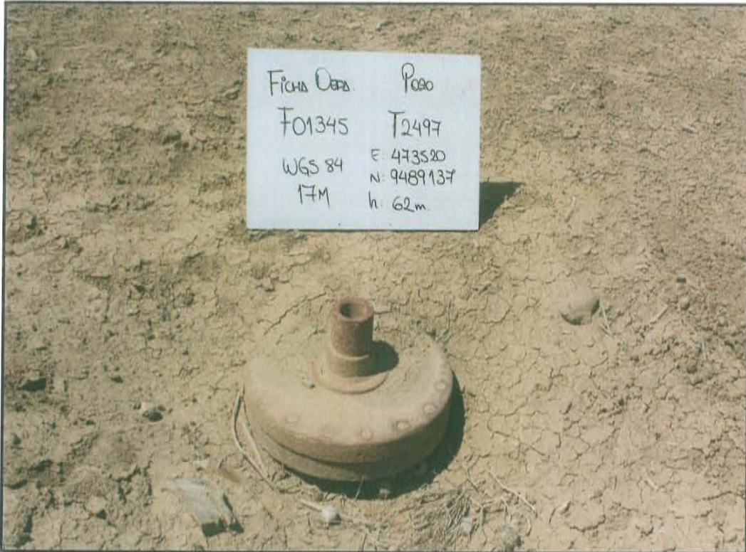
Fotografía N° 1. Pozo T 2497 presenta cabezal de pozo compuesto por brida de 18 plg y tubo de salida de 3,5 plg.
