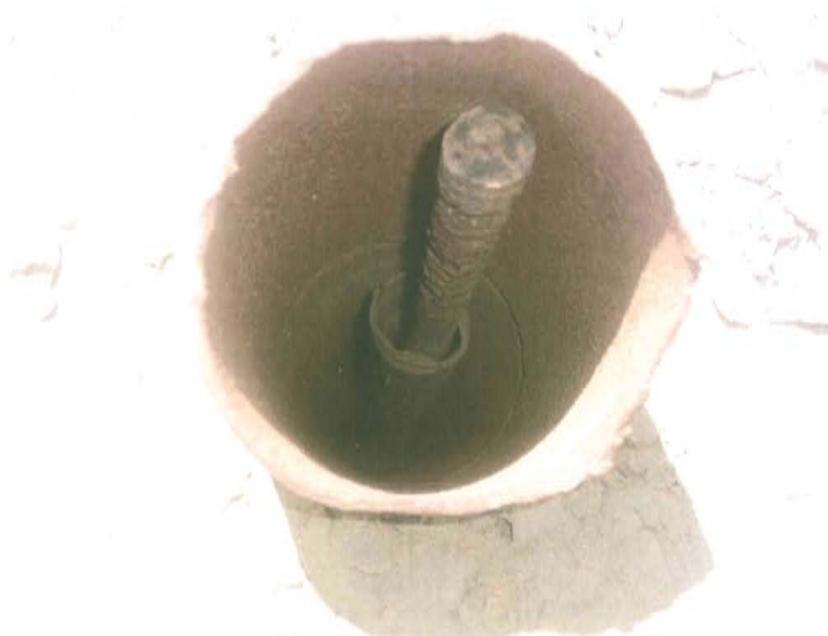
Fotografía N° 1. Pozo T_682, presenta casing abierto, del cual se percibe emisiones gaseosas.
