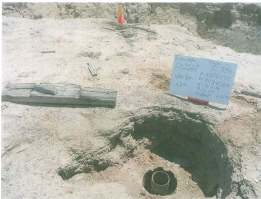
Fotografía N° 1. Se observa dos casing concéntricos que se encuentran abiertos al ambiente.
