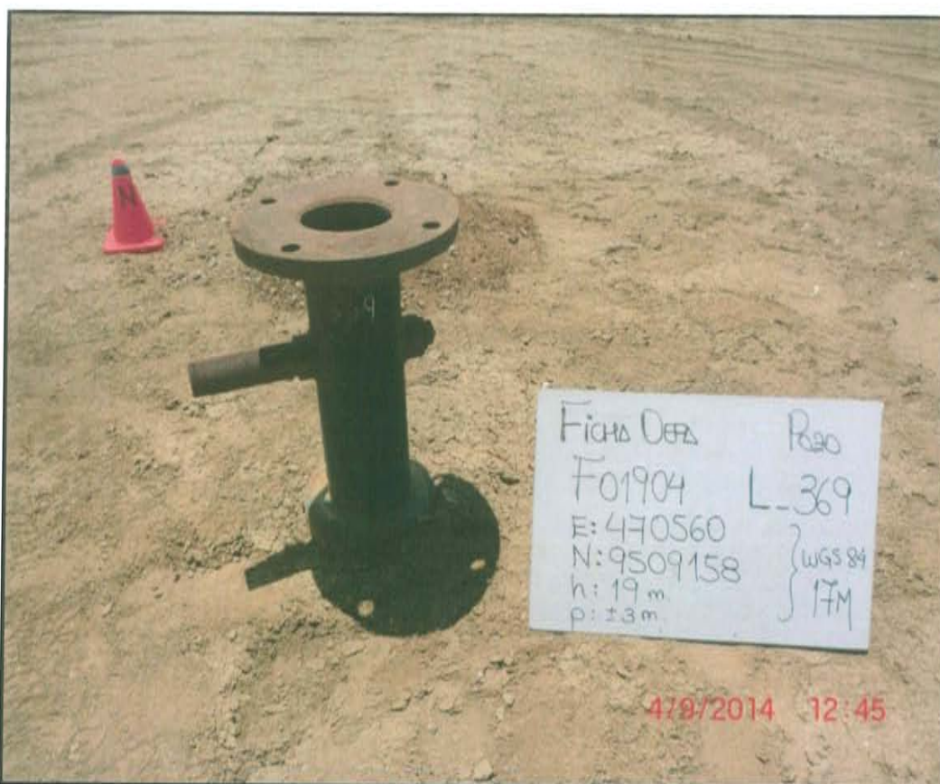
Fotografía N° 1. Cabezal del pozo que emerge 0,6 m desde el nivel de suelo y que está compuesto por brida unida al casing.
