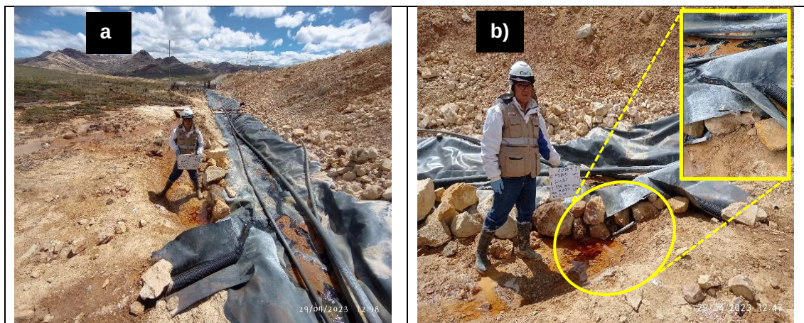
Figura 7.14. a) Vista panorámica de la filtración 1 y b) Ubicación de la filtración 1 proveniente del empalme entre geomembranas canal de contacto de la poza de tratamiento SP-02
