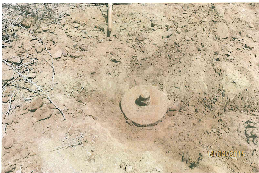
Fotografía N° 2. Se observa que la estructura del pozo, se encuentra en evidente estado de corrosión por lo que no garantizaría el hermetismo del pozo.
