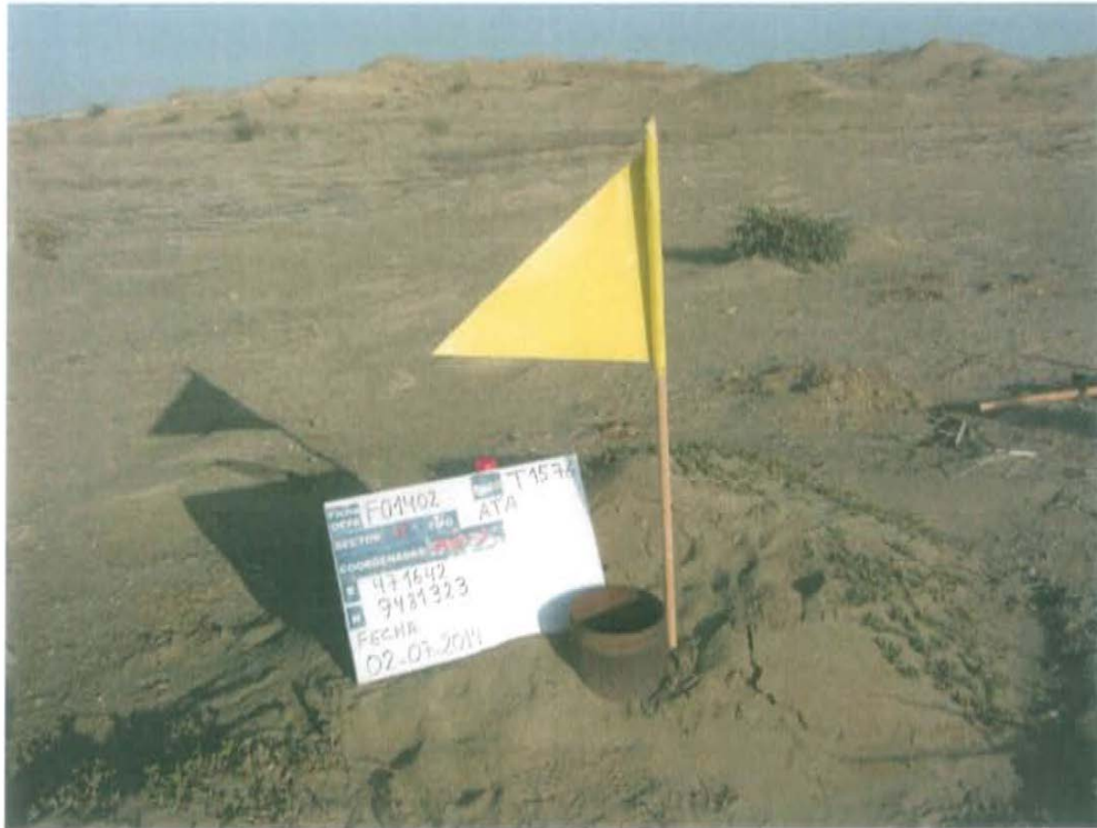
Fotografía N° 1. Se observa el Pozo T1576 con casing corroído de 8,5 pulgadas aproximadamente sin cabezal ni válvulas que aseguren su hermetismo.
