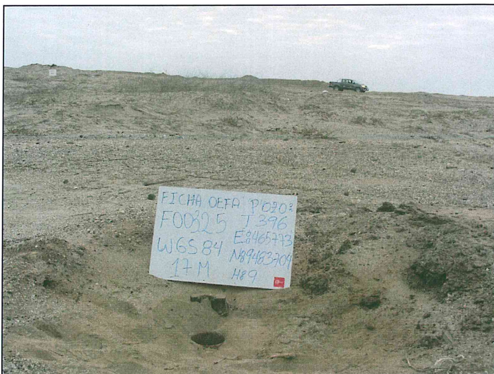
Fotografía N° 2. Pozo T_396 con Ficha OEFA F00325, pozo inactivo se observa el casing cortado, abierto sin cabezal ni válvulas de cierre que asegure su hermetismo.
