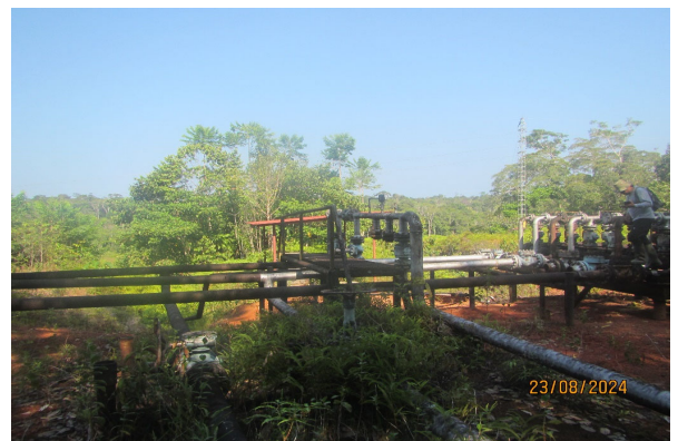
Vista del Manifold de campo, en donde se observaron líneas de flujo, bridas y válvulas sobre soportes metálicos en proceso de corrosión.
