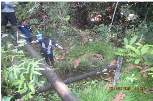
Vista de los ductos de los pozos DORI-01X, DORI-02CD, DORI-03D y DORI-04D ubicados en la Plataforma A que van hacia la Batería Dorissa.
