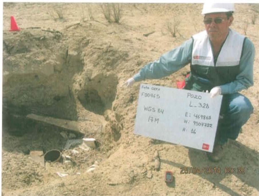
Fotografía N° 1. Pozo L_328, presenta casing abierto al ras del suelo.
