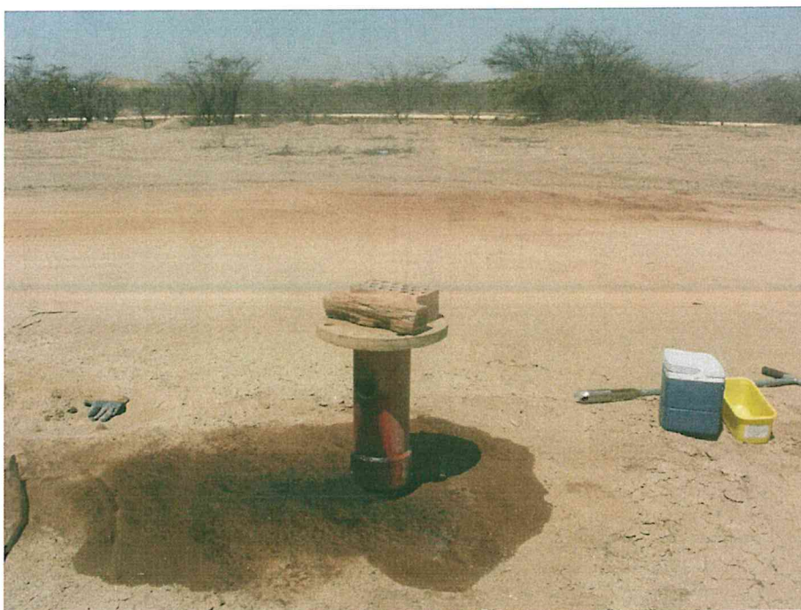
Fotografía N° 2. El pozo LJ_25 sobresale 0,5m de la base del terraplén, se encuentra abierto sin elementos de cierre que garanticen un cierre hermético del pozo.
