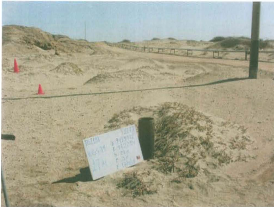
Fotografía N° 1. El pozo T1277 presenta tubería de revestimiento corroído, abierto de 6,5 pulgadas de diámetro sin ningún elemento de cierre que garantice su hermetismo.
