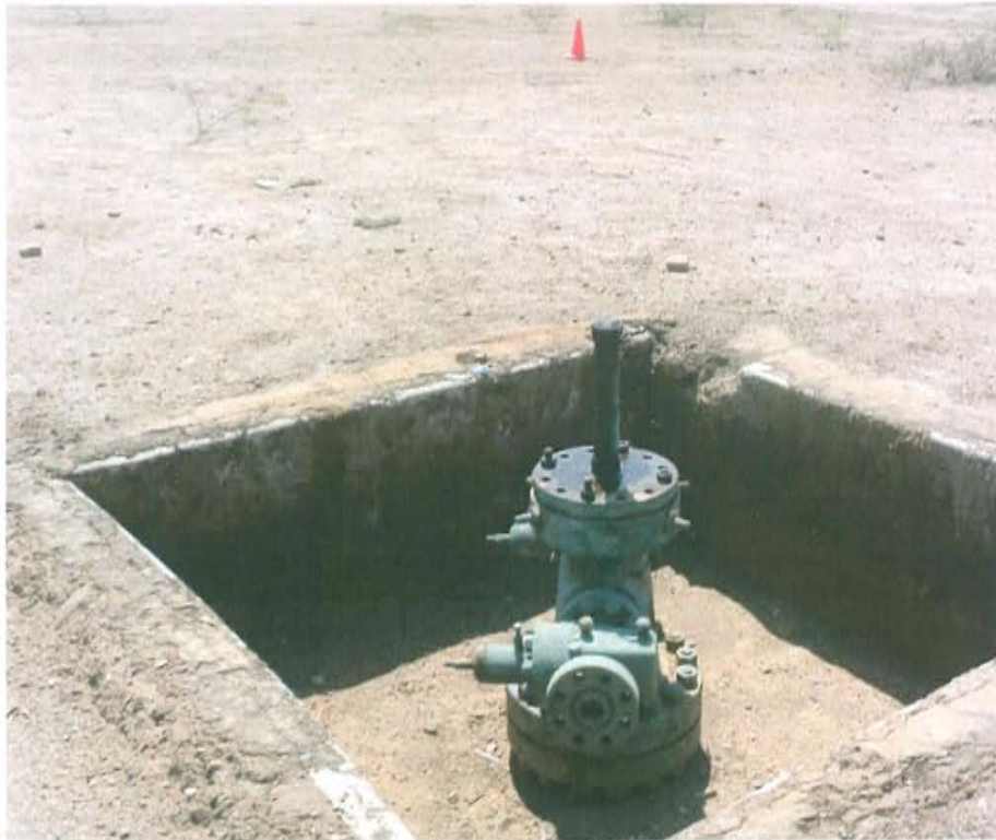
Fotografía N° 01.- Pozo inactivo con código PERUPETRO T5969 y con código Ficha OEFA F01120, se observa el cabezal compuesto por un arreglo de bridas reductoras y tuberías de reducción sin alguna válvula de cierre por lo que se encontraría expuesto al ambiente.
