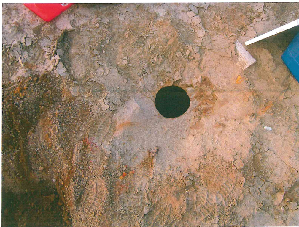
Fotografía N° 2. Pozo T1832 ubicado al ras de suelo, no presenta cabezal y se encuentra abierto al ambiente sin elementos de cierre que garanticen su hermetismo.
