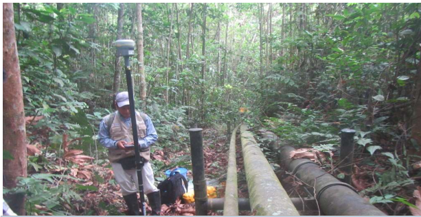
Vista de los ductos (línea de tuberías, conformada por 2 tuberías de 16 pulgadas de diámetro y 1 tubería de 4 pulgadas de diámetro), asociados al transporte de hidrocarburos desde la Batería 9 - Pavayacu hacia la Estación de Bombas Capirona.
