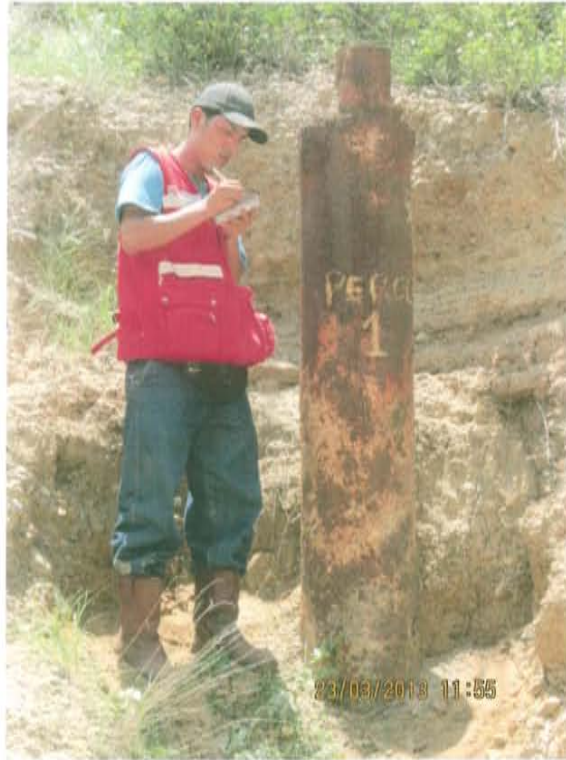
Fotografía N° 1. Pozo con código PERUPETRO NN15-XX inactivo mal abandonado, se observa casing que sobresale 2,0 m sobre el nivel de la superficie.
