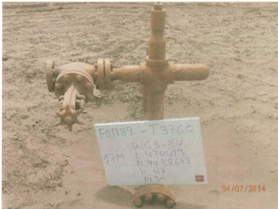
Fotografía N° 1. Pozo inactivo se encuentra expuesto al ambiente.
