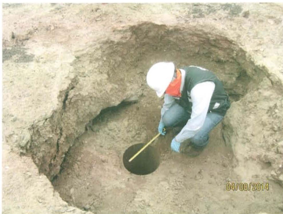
Fotografía N° 3. Se observa casing al ras del suelo de aproximadamente 16 pulgadas del Pozo T1720, de donde se percibe emisiones gaseosas fugitivas.
