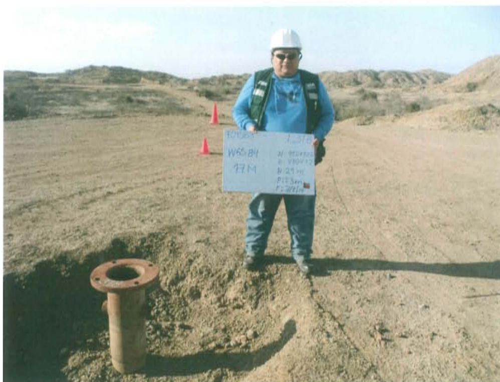
Fotografía N° 1. Vista del Pozo L_318, presenta casing con brida que sobresale 0,65 m sobre el nivel del suelo y sin elementos de cierre.
