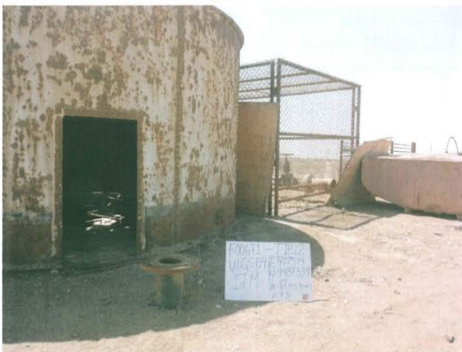
Fotografía N° 1. Pozo inactivo con código PERUPETRO T1812, posee casing y brida corroídos.
