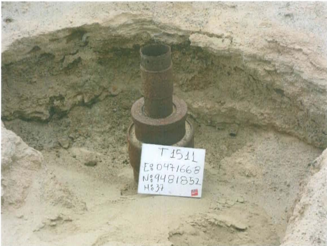
Fotografía N° 1. Se observa dos (02) casing concéntricos cementados en la sección anular y en su interior sale el casing de producción abierto al ambiente.
