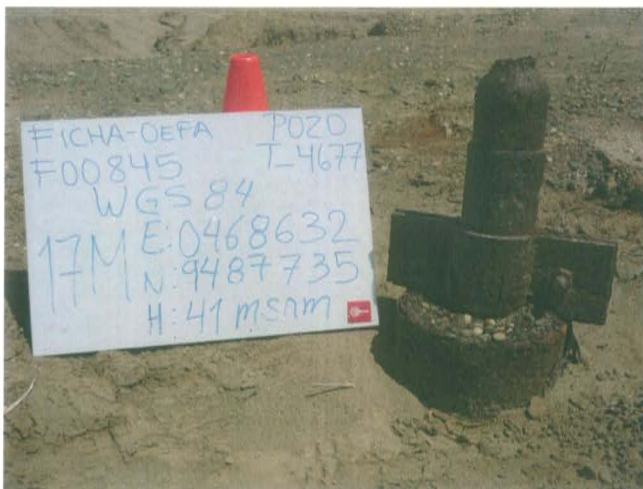
Fotografía N° 1. Pozo T_4677, presenta casing con tubería de reducción, corroído y abierto.
