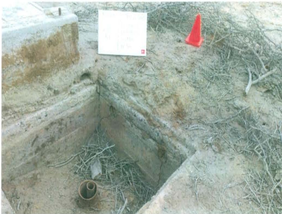
Fotografía N° 1. Vista de ubicación del pozo donde se observa el pozo con el casing y tubing abierto en estado de deterioro dentro de una cantina.
