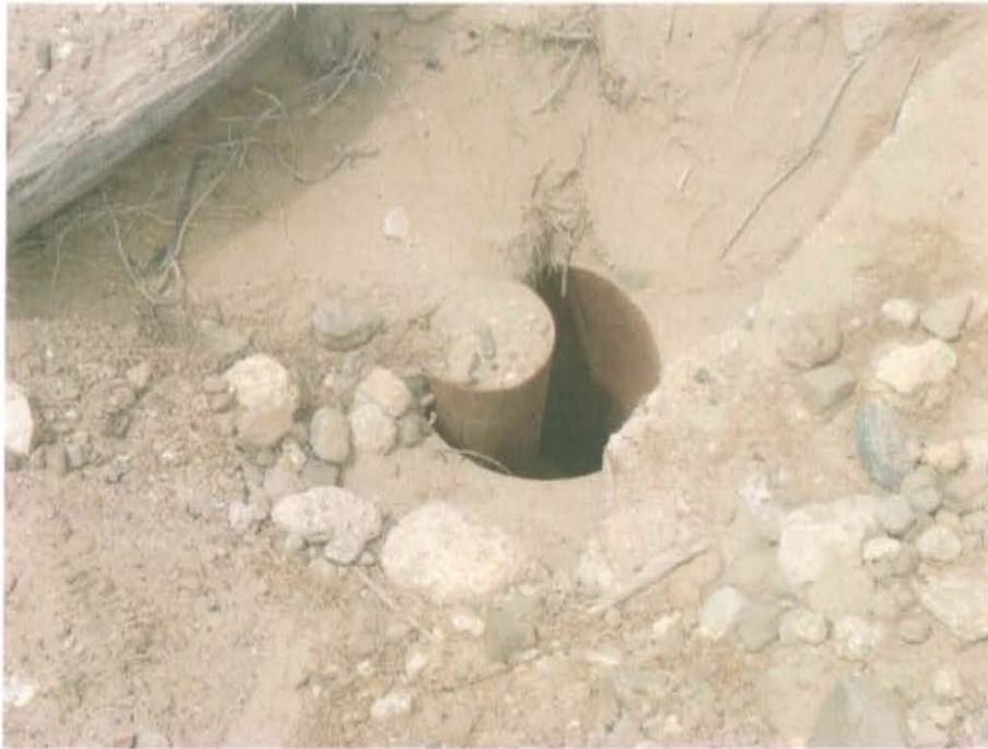
Fotografía N° 1. Se observa el pozo inactivo con casing y tubing corroído bloqueado con tierra y piedras, sin elementos de cierre en superficie, por lo que se encuentra abierto.
