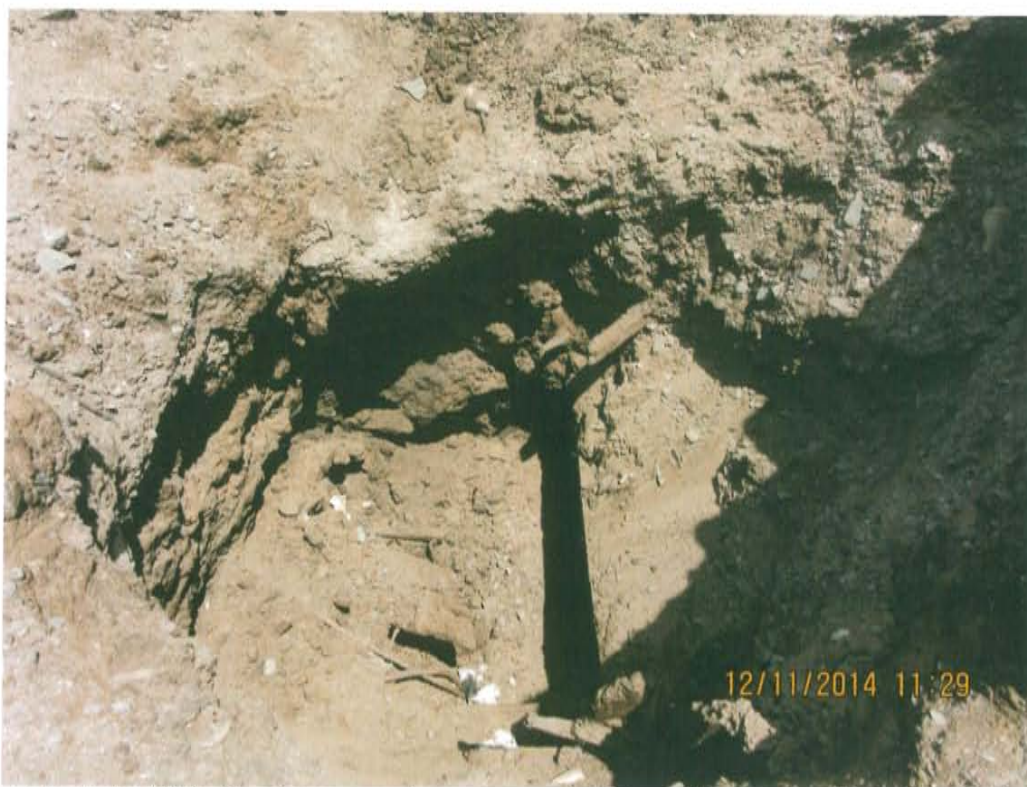
Fotografía N° 1. Se observa un hoyo con restos de maderas y suelo contaminado con hidrocarburos en los alrededores del área del pozo T1714A.
