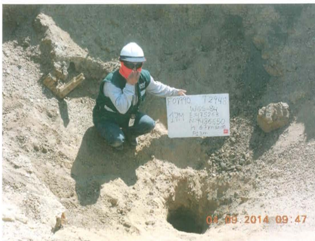
Fotografía N° 1. Pozo con código PETRUPETRO T2948 inactivo mal abandonado que se encuentra abierto al ambiente
