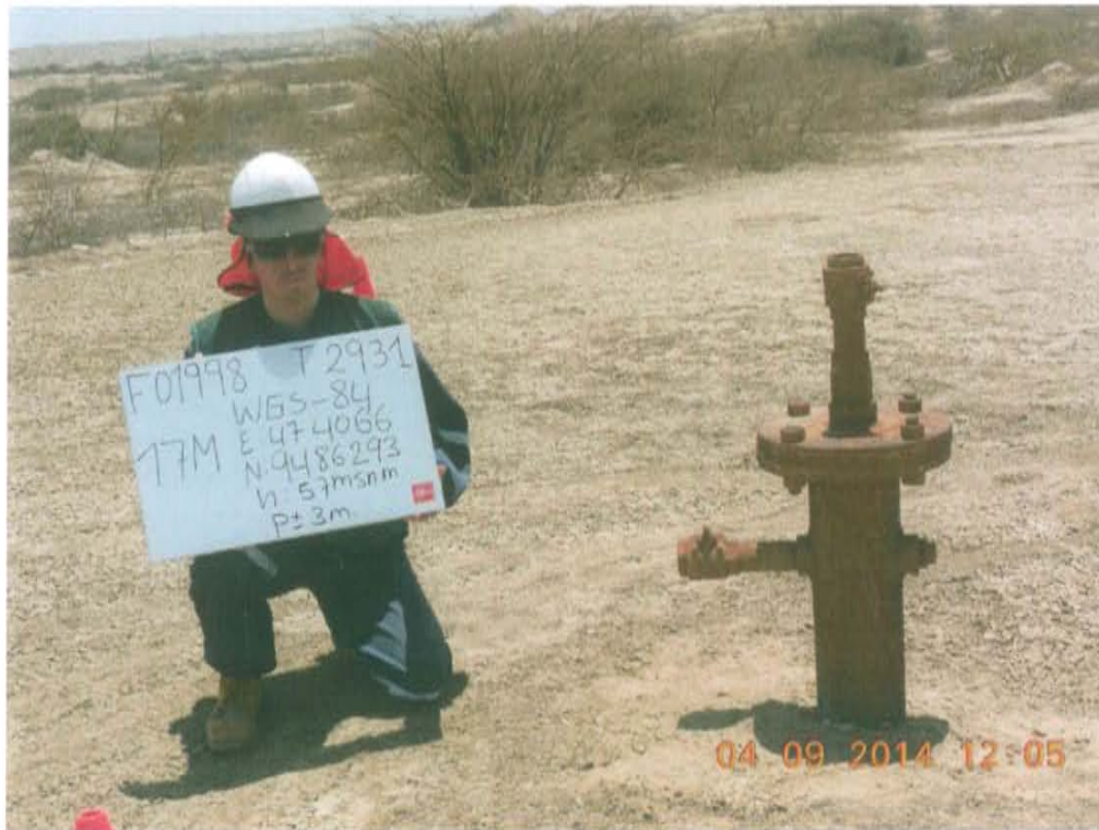
Fotografía N° 1. Identificación del pozo inactivo con código PERUPETRO T2931. Presenta casing con brida adaptadora, tubería de reducción y tubo lateral con válvulas deterioradas que no asegurarían el hermetismo del pozo.
