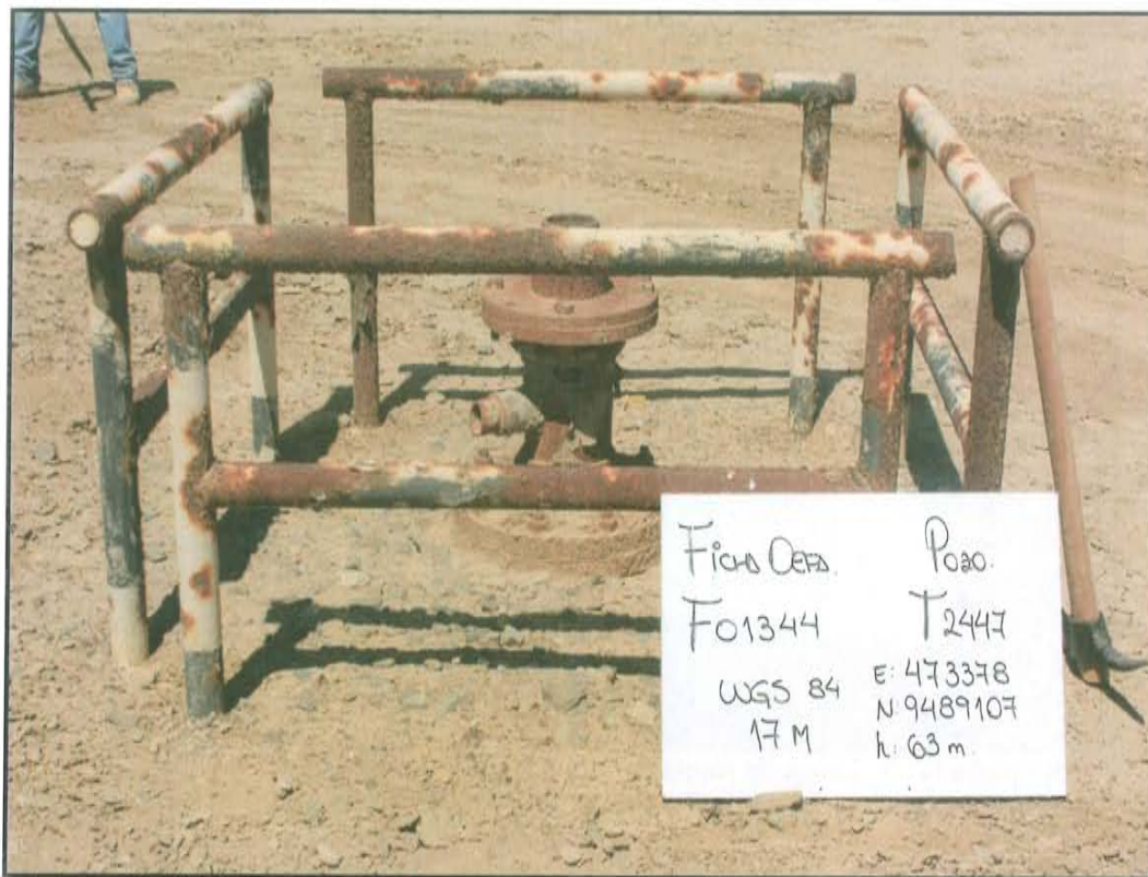
Fotografía N° 1. Pozo T 2447 presenta cabezal de pozo que emerge a una altura de 0,6 m desde la superficie del suelo y que cuenta con cerco de fierro corroído de 1 m de altura.
