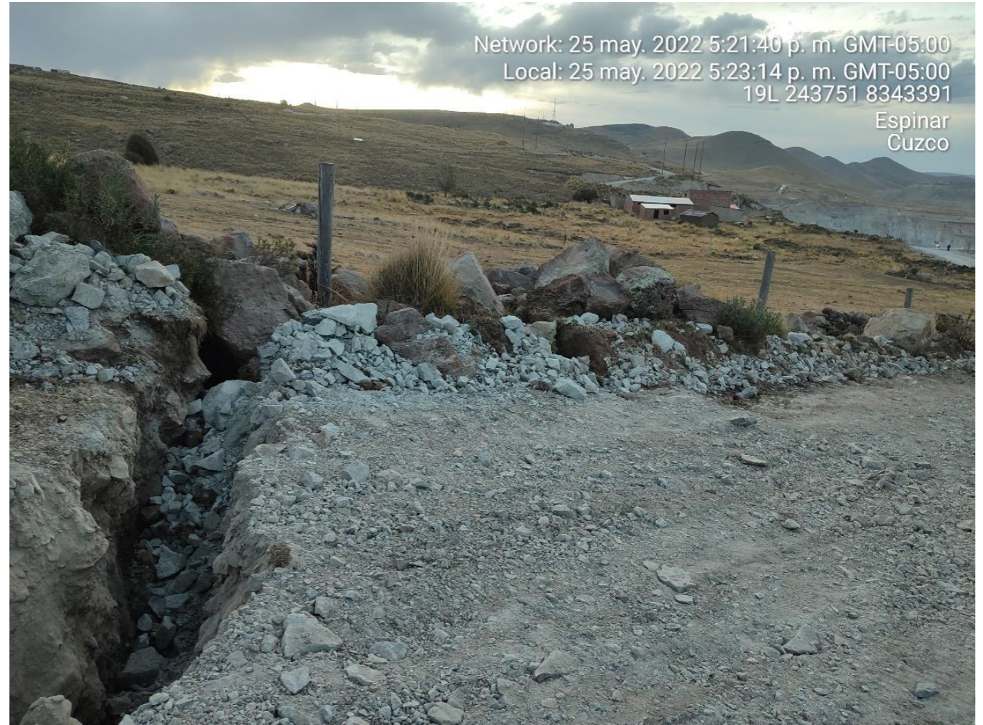
Fotografía N° 08. Deslizamiento activo ubicada al sur del Tajo Sur.
