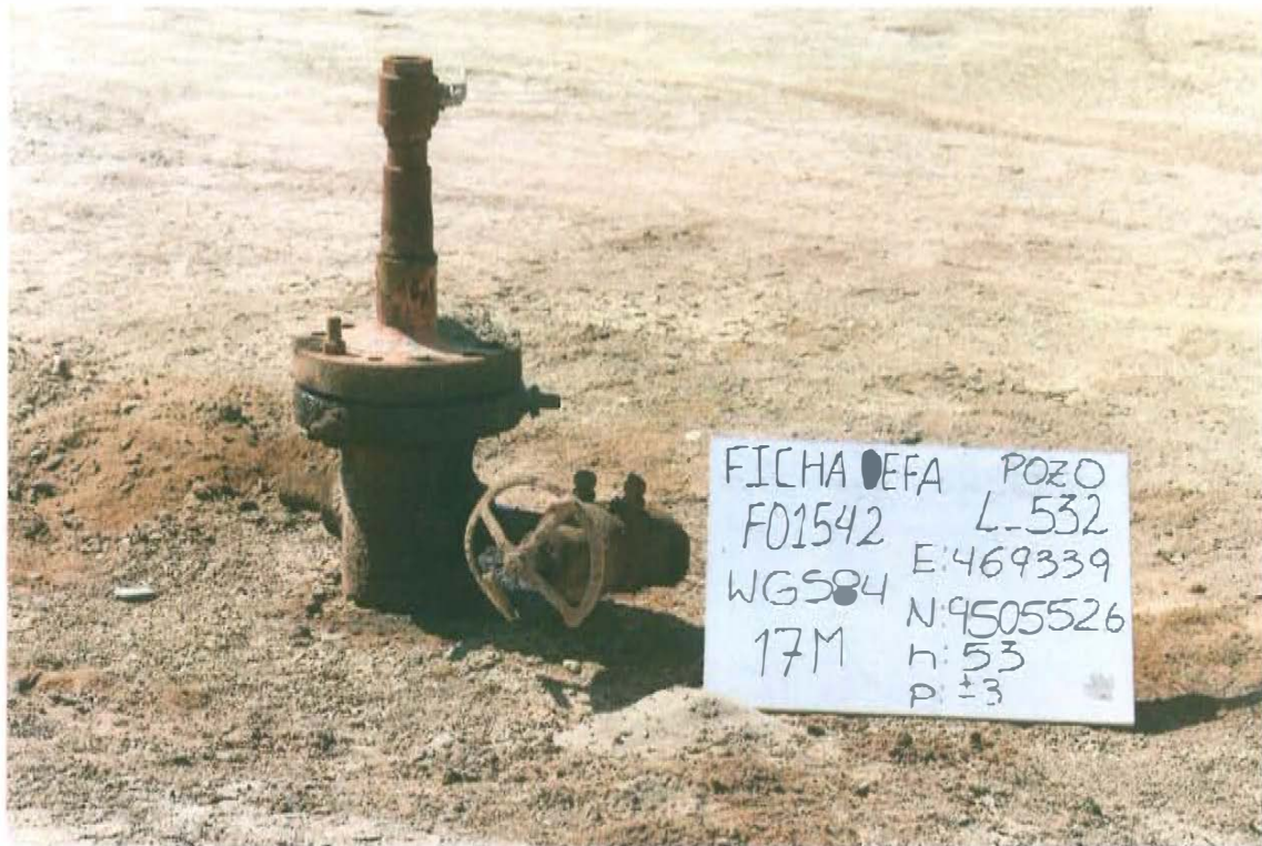
Fotografía N° 1. Identificación del pozo inactivo con código PERUPETRO L_532. Presenta casing, brida con válvula reductora y válvula lateral deterioradas que no aseguran el hermetismo del pozo.
