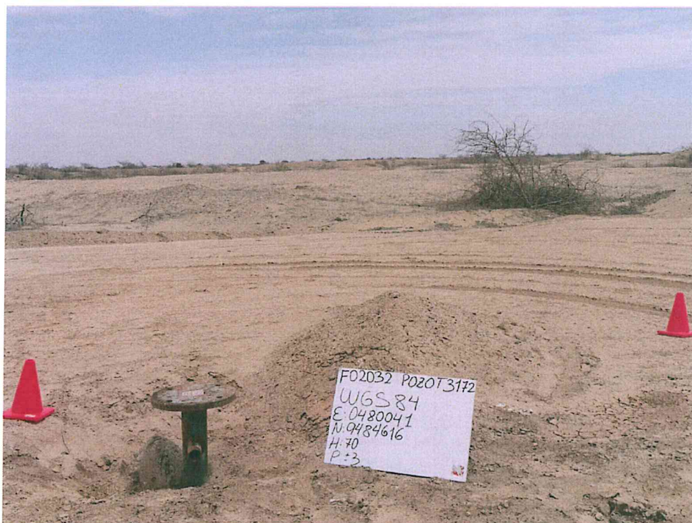
Fotografía N° 1. Pozo T3172, presenta casing abierto al ambiente a una altura de 0,47 m sobre el nivel del suelo del hoyo dentro de un hoyo de 0,3 m de profundidad.
