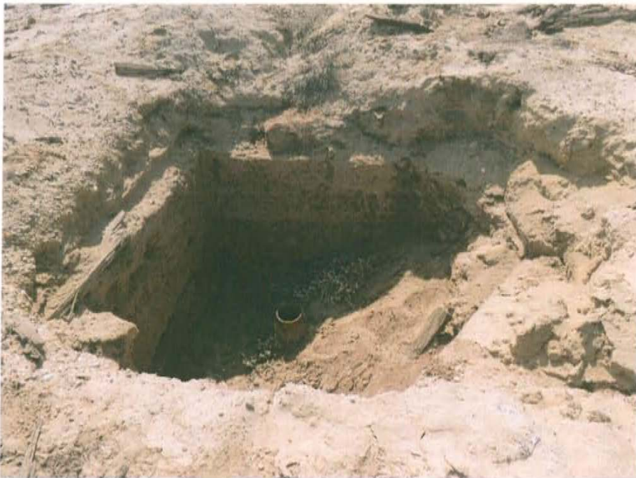
Fotografía N° 2. Se aprecia casing abierto, sin elementos de cierre en superficie que garanticen un cierre hermético del pozo.
