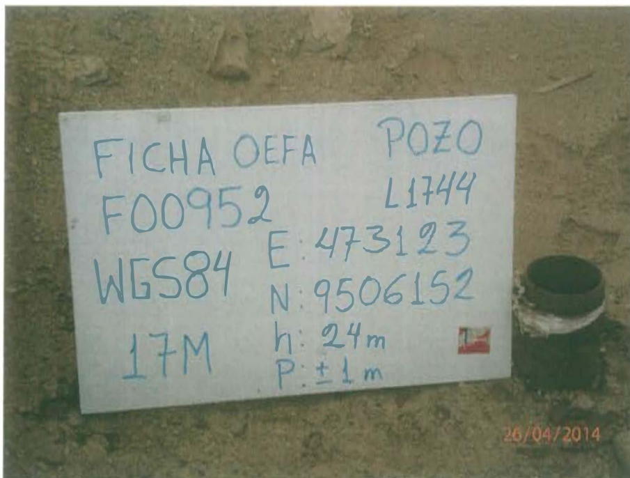
Fotografía N° 1. Pozo L1744, presenta casing de aproximadamente 6 pulgadas de diámetro, cortado y corroído.
