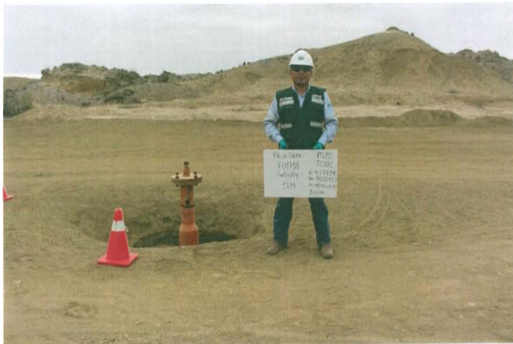
Fotografía N° 2. Vista del Pozo evaluado, se visualizó un casing corroído y expuesto de 12,5" de diámetro y de 1,4 m de altura sobre el nivel del suelo de un hoyo, el cual presentaba una brida de 15" de diámetro y dos válvulas pero que debido a su estado de corrosión probablemente no asegurarían su hermetismo.
