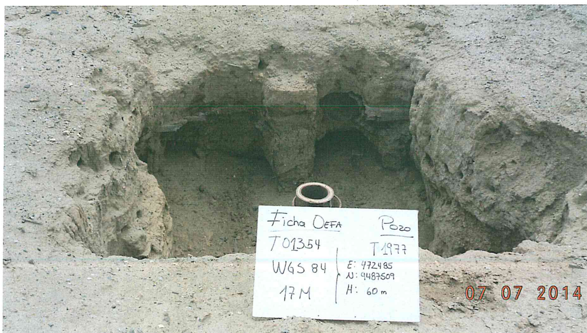
Fotografía N° 2. Pozo abierto y expuesto al ambiente, sin accesorios que aseguren su hermetismo, el casing que sobresale 2,1 m del interior de un hoyo de sección irregular de 2,1 m de profundidad.
