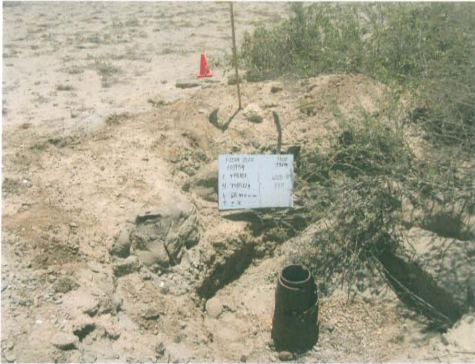
Fotografía N° 1. Se observa el Pozo T3244 con doble casing de 7 y 10 pulgadas aproximadamente en avanzado estado de corrosión abiertos y expuestos al ambiente.
