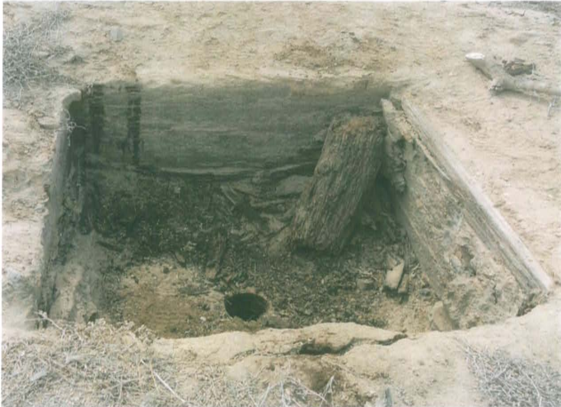
Fotografía N° 01.- Pozo con código PERUPETRO T2577 con Ficha OEFA F01215, se observa el casing dentro de una cantina a nivel de la superficie del suelo sin cabezal ni válvula de cierre por lo que se encuentra abierto al ambiente.
