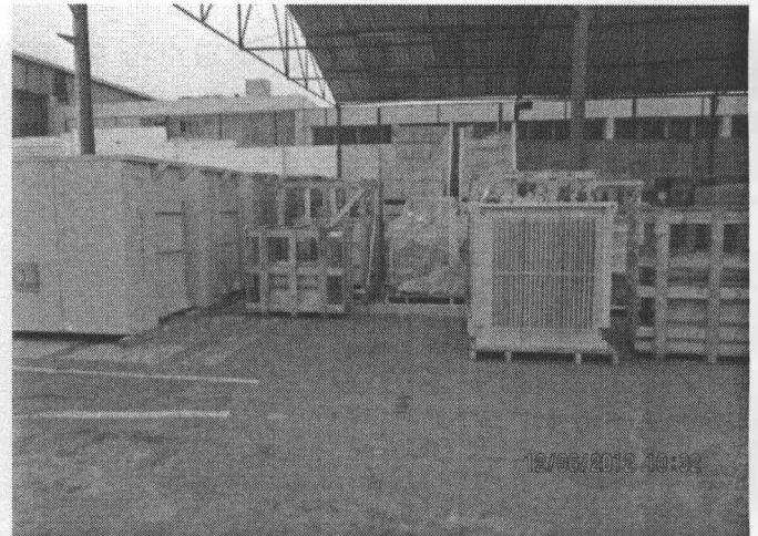
Fotografías N° 3- Transformadores nuevos de propiedad de EDELNOR S.A.A. en el Almacén de NEPTUNIA
