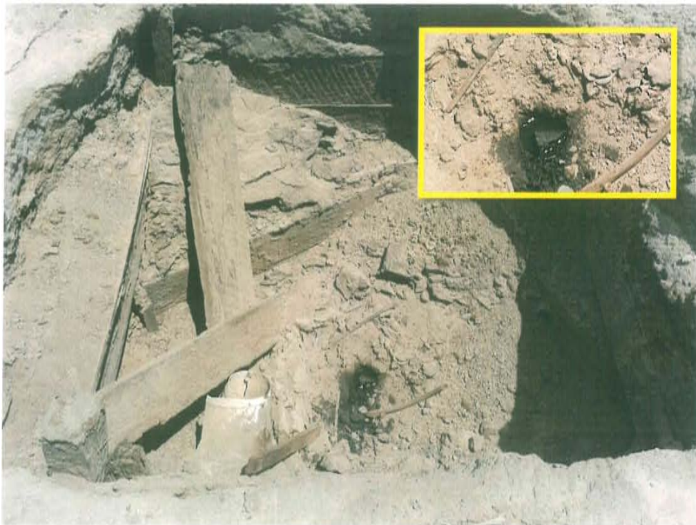
Fotografía N° 2. Vista del interior del hoyo donde se observa el casing con presencia de hidrocarburo líquido y restos de madera en su interior.
