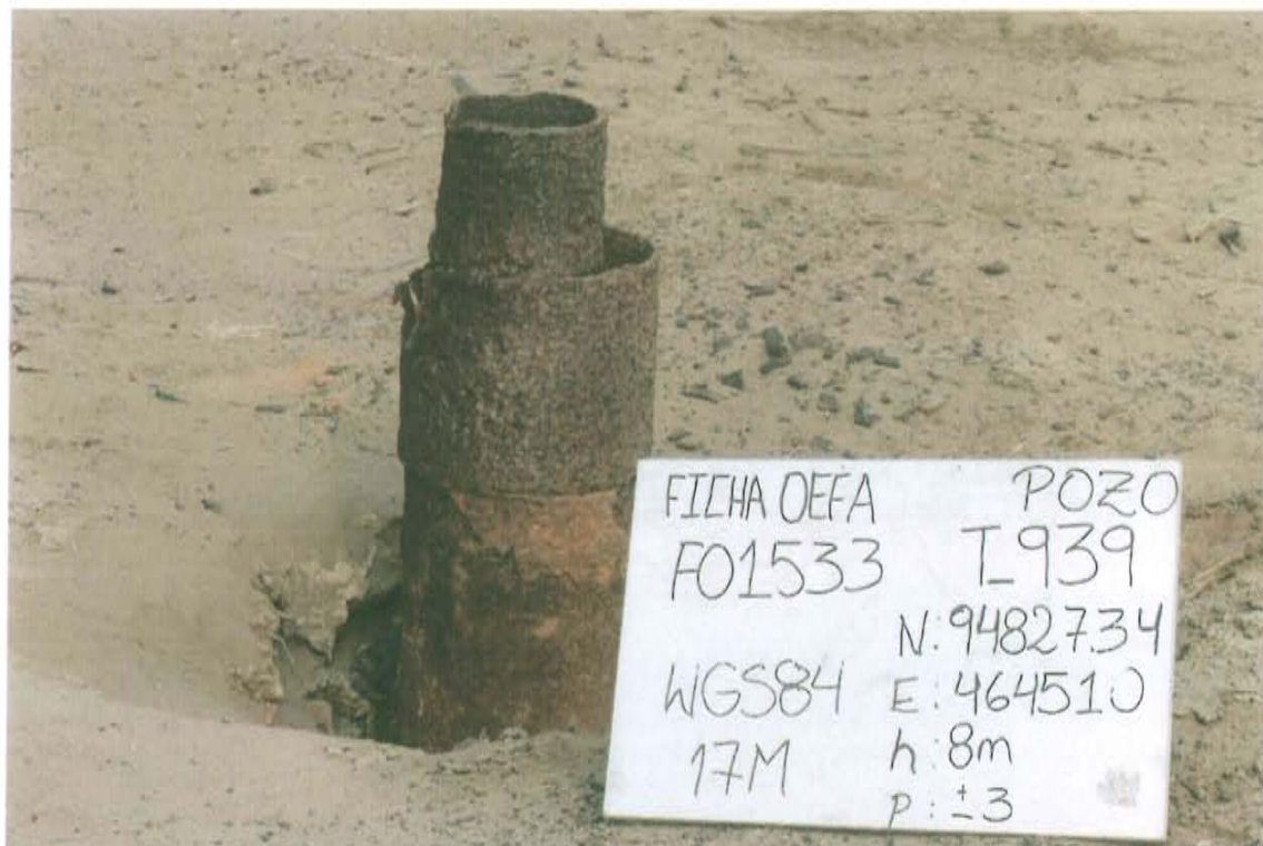
Fotografía N° 1. Identificación del pozo inactivo con código PERUPETRO T_939. Presenta dos casing corroídos sin cabezal o válvulas que aseguren su hermetismo.
