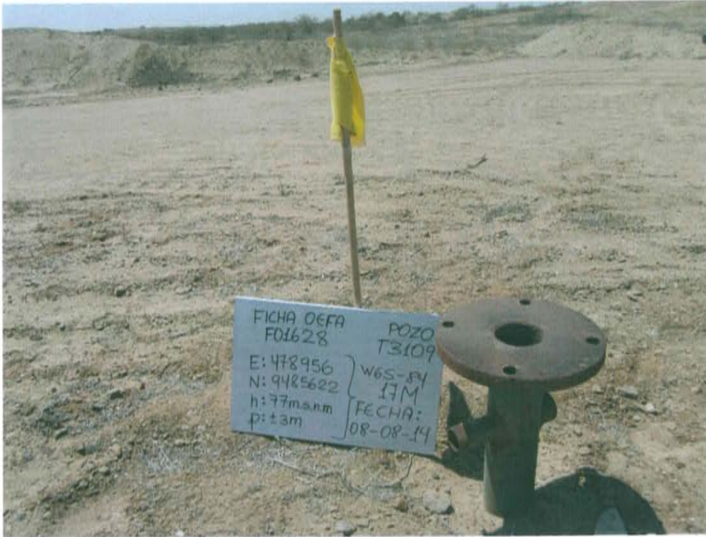
Fotografía N° 1. Pozo inactivo con código PERUPETRO T3109. Se observa casing con brida sin cabezal.
