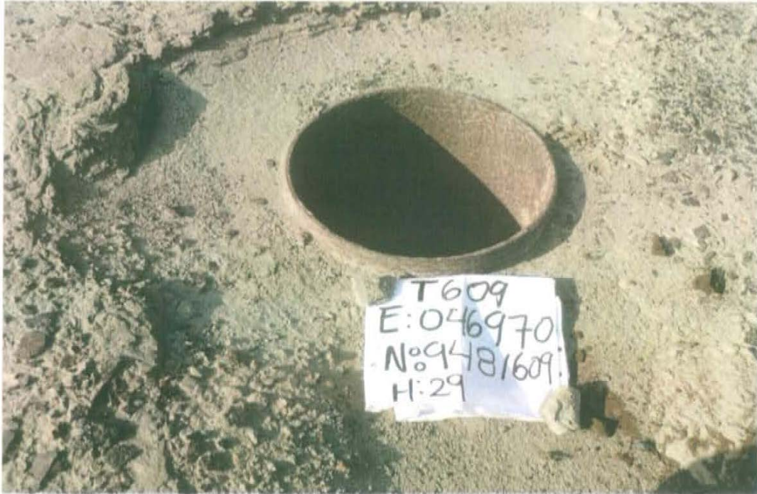
Fotografía N° 1. Vista de ubicación del pozo se observa el casing abierto y la brida en estado de corrosión, sin elementos de cierre que garanticen su hermeticidad.
