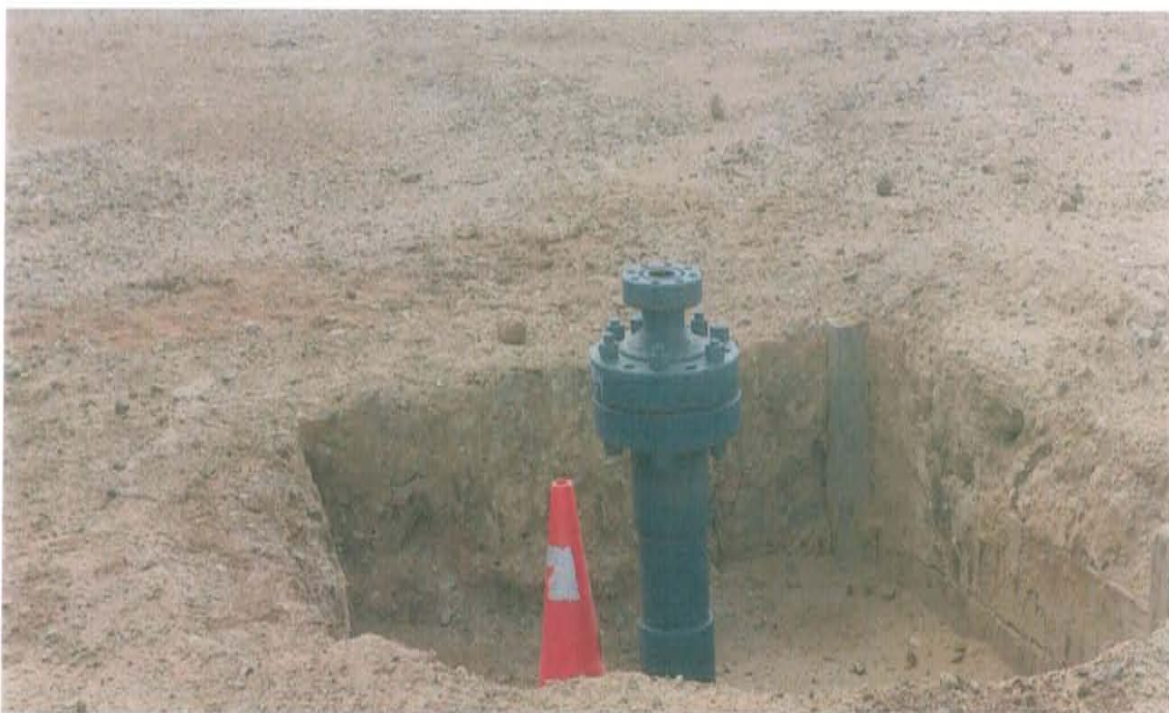
Fotografía N° 1. Pozo con código Ficha OEFA F01260 y con código PERUPETRO T5034, se observa el casing unido a un cabezal compuesto por una brida y una reducción sin válvula de cierre por lo que se encuentra expuesto al ambiente.
