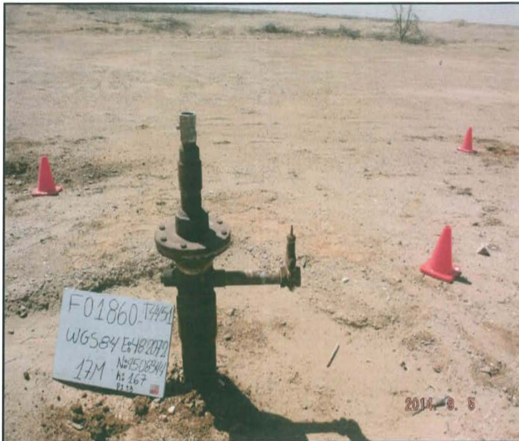
Fotografía N° 1. Pozo inactivo con cabezal compuesto por brida y válvulas corroídas.
