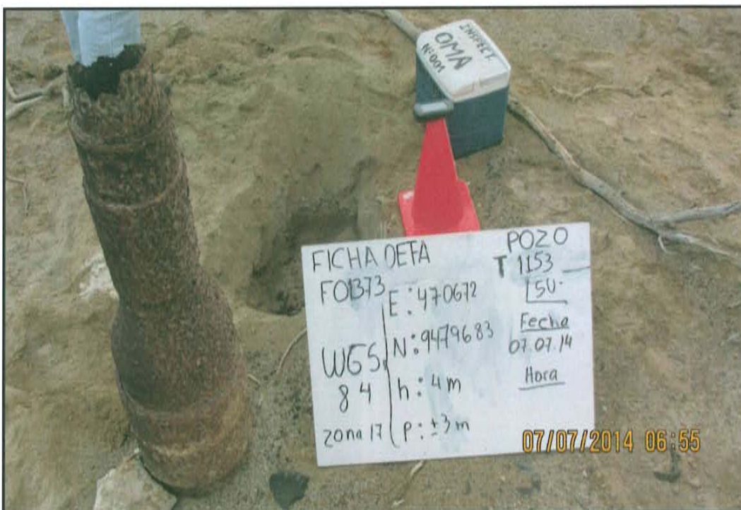
Fotografía N° 2. Se observa el pozo PETROPERU T1153 con casing corroído que emerge a una altura de 0,6 m desde la superficie del suelo.
