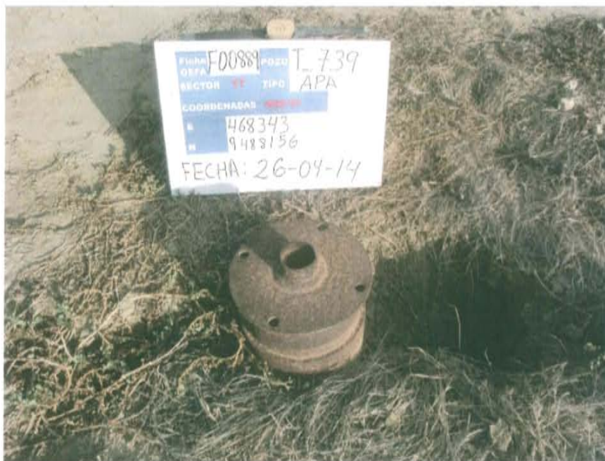
Fotografía N° 1. Pozo T_739, presenta casing con tubería de reducción y brida abierto al ambiente.
