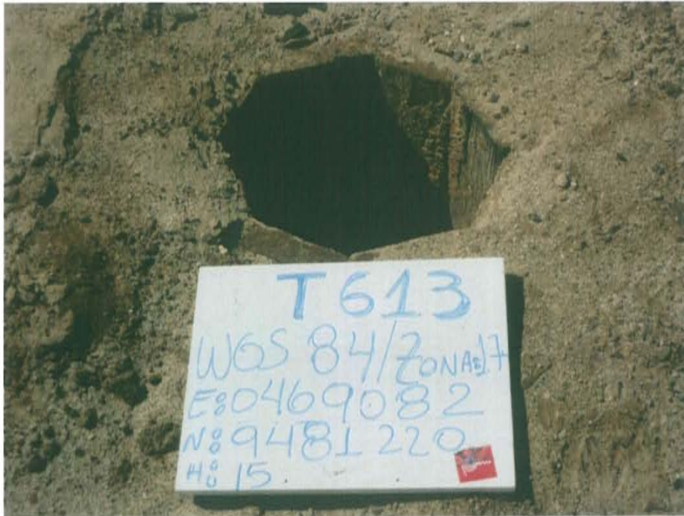
Fotografía N° 1. Pozo inactivo T_613, presenta conductora de madera abierta a nivel del suelo.
