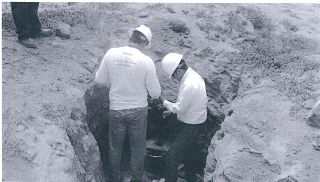
Fotografía 1-3: Estado de la cantina del pozo 4298 Boca
