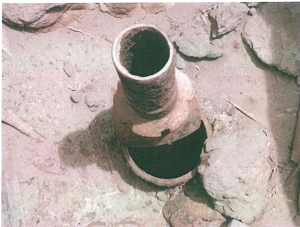
Fotografía N° 3. Presenta dos (2) casing, uno de ellos deteriorado y ambos sin elementos de cierre que aseguren su hermetismo por lo que se encuentran abiertos.
