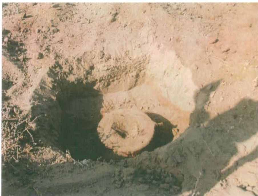
Fotografía N° 1. Pozo T2514 presenta casing corroído, con brida de 35 pulgadas, sin cabezal y con orificio de reducción de 7 pulgadas arenado.
