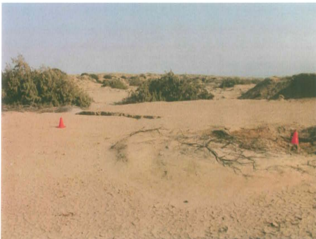
Fotografía N° 3. El terraplén presenta procesos erosivos y la vegetación típica se encuentra fuera del terraplén.
